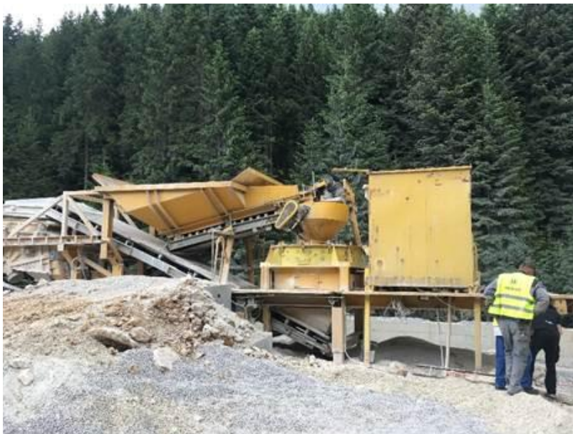
Slika 3 – Prikaz drobilnog postrojenja za preradu agregata koje će biti postavljeno na predmetnoj lokaciji
